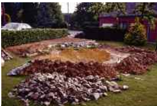
Aménagement d'un parterre qui servira de tableau de fond à la mare
