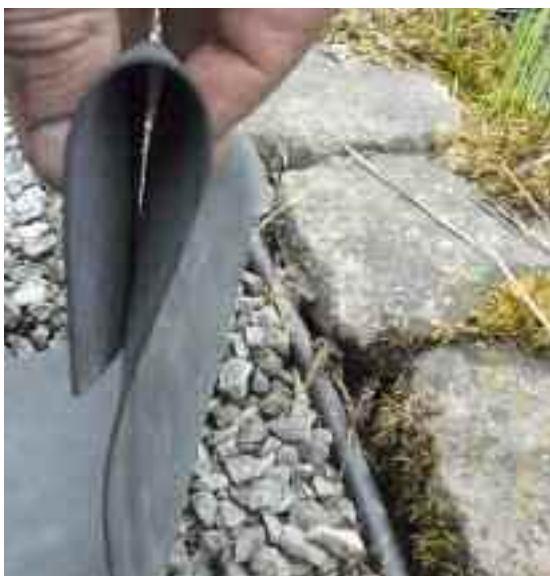
Une pierre plate, une membrane remontant à la verticale dans une zone plantée, quelques galets suffisent généralement pour la faire disparaître.
